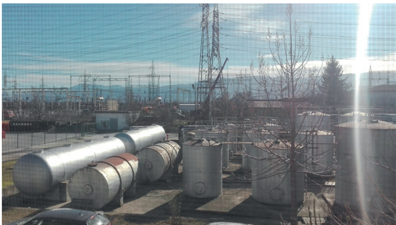
Общ поглед на Базата за регенерация на трансформаторни масла и подстанция 400/110 kV Пловдив
